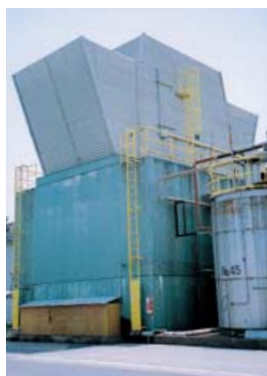
甚目寺工場冷却水回収装置
