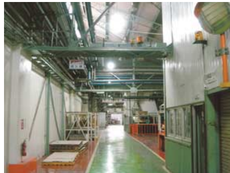
本社工場の高効率照明器具
