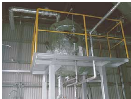
アイカハリマ工業(株)におけるドレン水回収の状況
