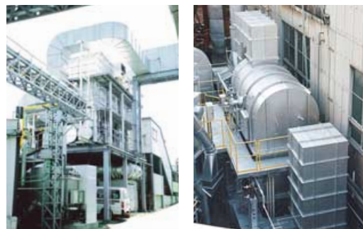
本社工場排ガス燃焼処理装置(4基)
