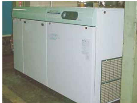
本社工場のインバーター制御式コンプレッサー
